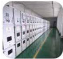
开关室 Switch gear Room
